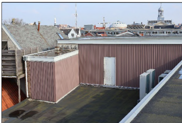
Figuur 8. Voorzijde dak met betimmering
