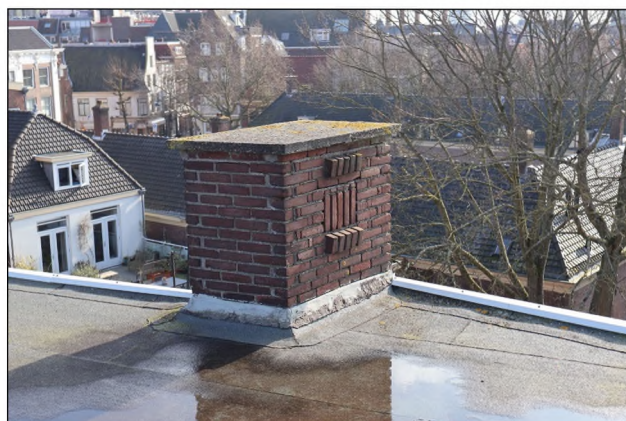
Figuur 11. Beluchtungskanaal nabij binnenplaats
