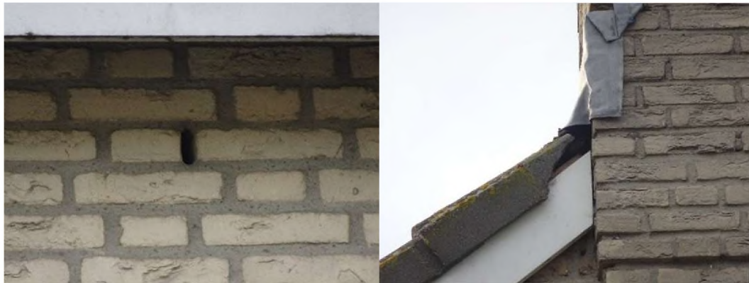
Figuur 3.1 Open stootvoeg (links) en gebroken kantpan (rechts) in deelgebied 1
