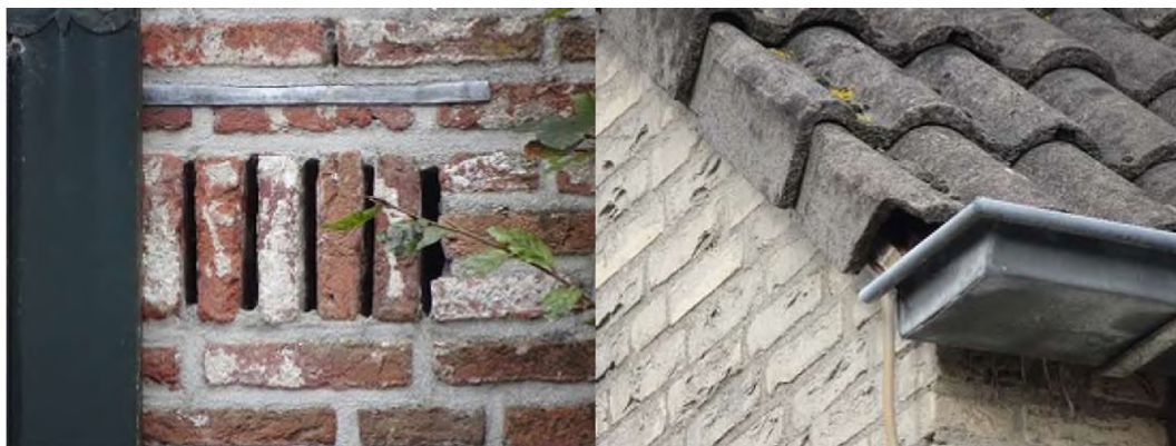
Figuur 3.3 Ventilatievoegen (links) en opening onder hoekpan (rechts) in deelgebied 1
