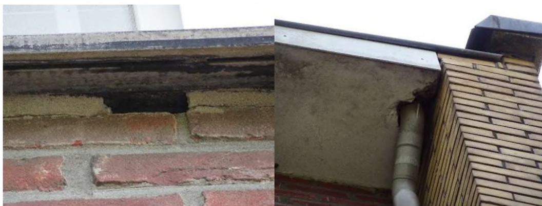
Figuur 3.6 Opening onder raamdorpel (links) en opening bij regenpijp (rechts) in deelgebied 2
