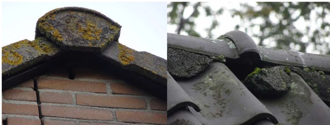
Figuur 3.2 Overstekende nokpan met open stootvoeg en dilatatievoeg (links) en opening onder nokpan (rechts) in deelgebied 1
