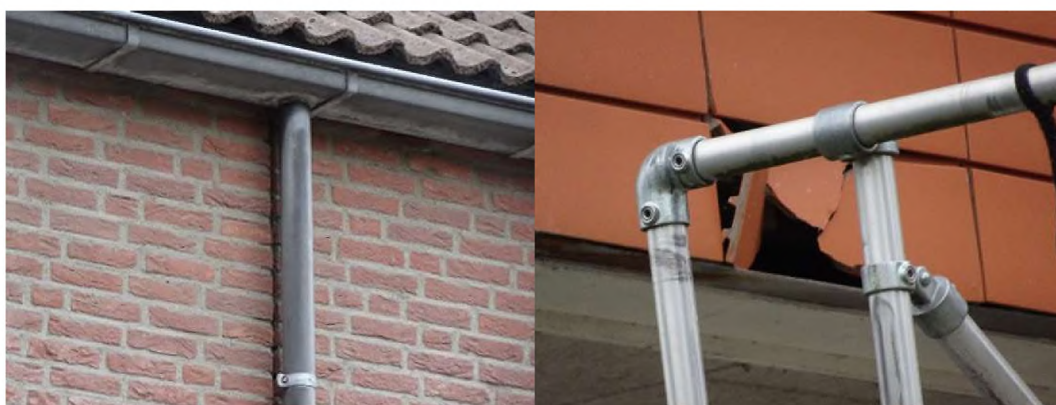
Figuur 3.8 Open dilatatievoeg achter regenpijp (links) en gebroken paneel in deelgebied 3 (rechts)
