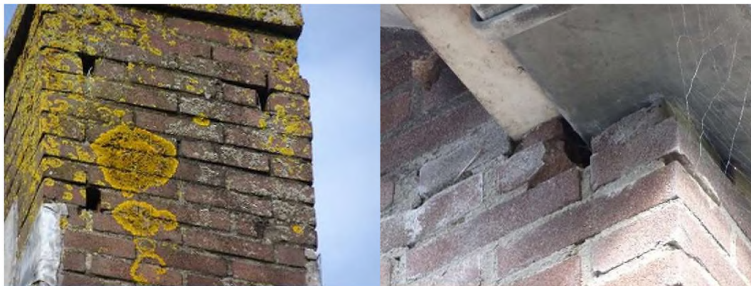
Figuur 3.5 Open stootvoegen in schoorsteen (links) en opening onder dakgoot (rechts) en in deelgebied 2
