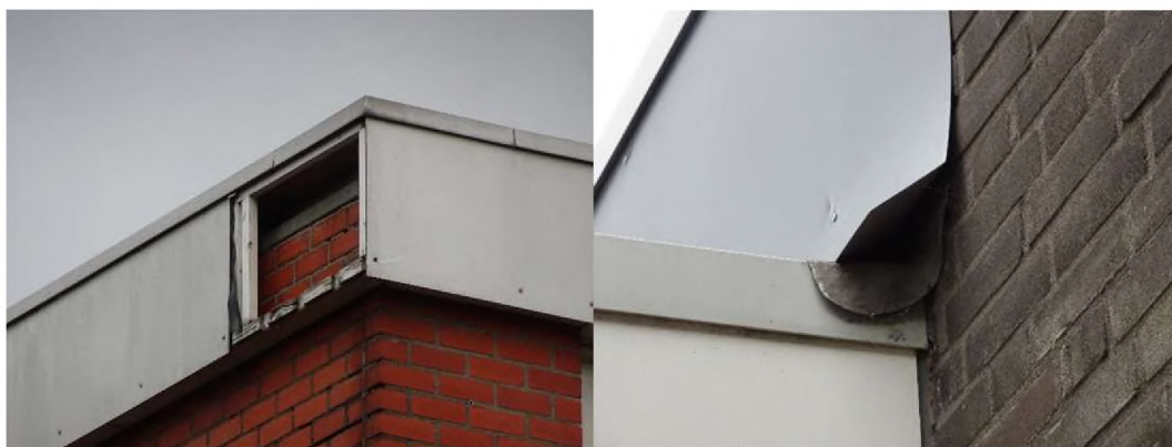
Figuur 3.7 missend paneel in deelgebied 2 (links) en gekromde gevelplaat in deelgebied 3 (rechts)
