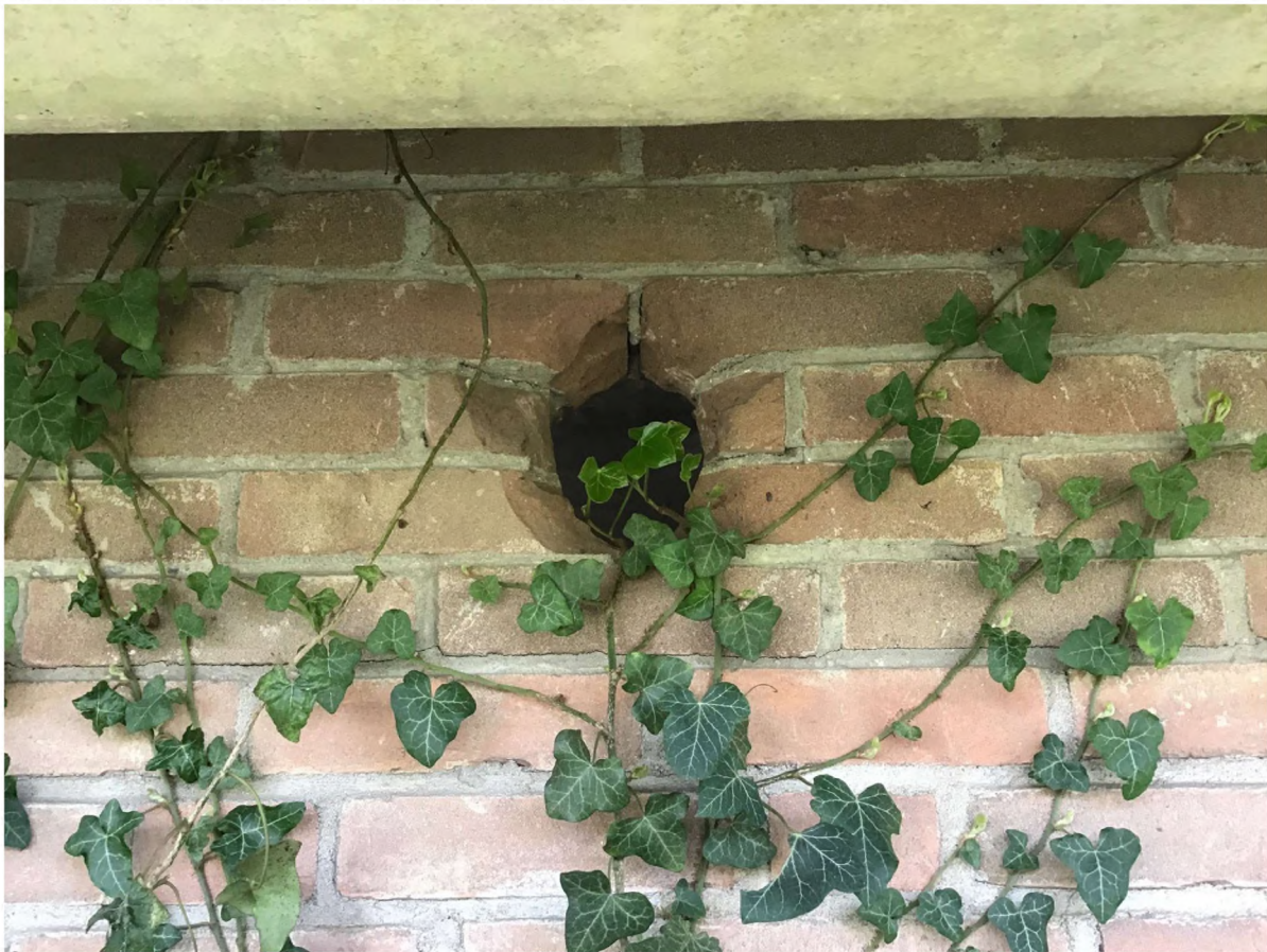
Afbeelding 43: Gat in de muur van het verlaten huisje.
