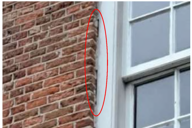
B. Openingen in voegwerk kozijn voorzijde slot
