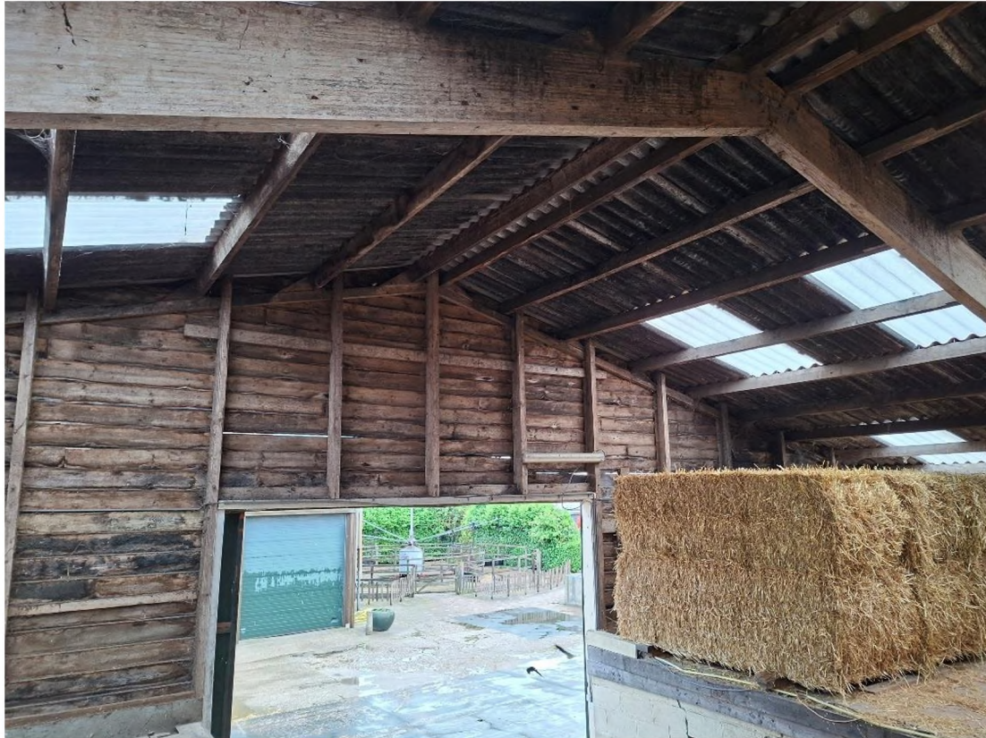
Figuur 3.3 Het ontbreekt aan wegruimtes achter de uit planken opgetrokken muren of het golfplaten dak
